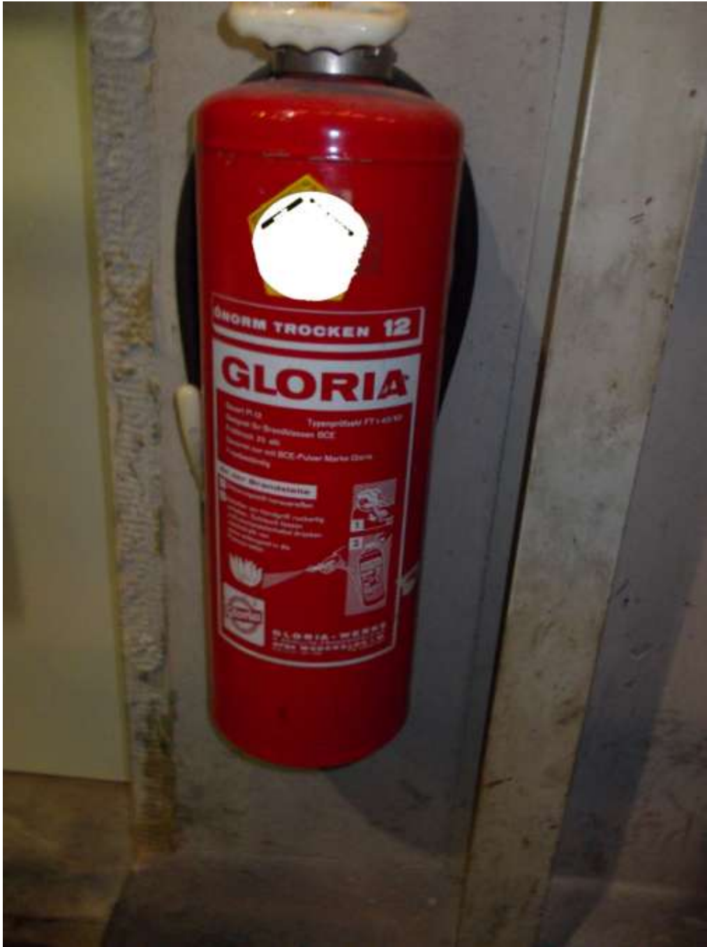
Bild 4: Dieser Feuerlöscher ist aus den frühen siebziger Jahren. Er hängt nach wie vor in einer Werkhalle in Wien. Das „Pickerl“ des Sachkundigen haben wir aus Mitleid übermalt.
